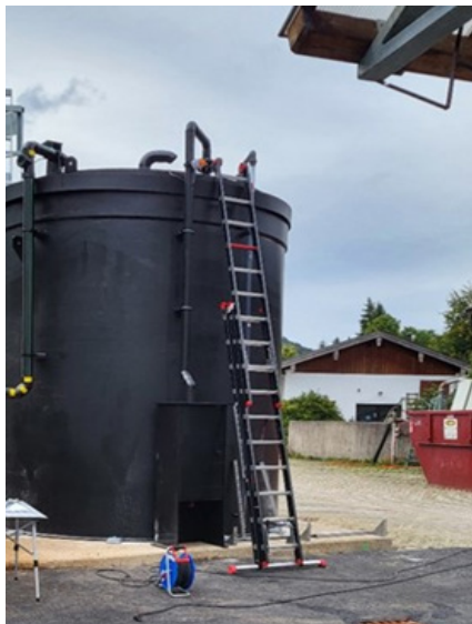
Der neue Lagertank für das Fällmittel
