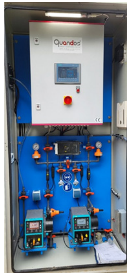
Technische Anlage zur Steuerung des Fällmittels
